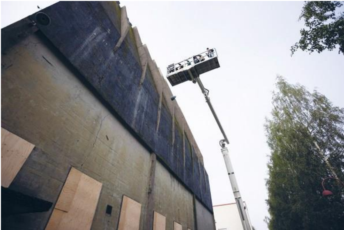
AALTOSIILO-timiä nostetaan siilon huipulle Hongisto Oy:n lainaamalla 35-metrisellä nostolavalla. Kuva: Otto Lowe / Factum Foundation.
